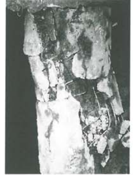
杭頭を剛接した杭の被害例
